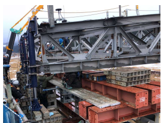
写真-7 たわみ取り設備
