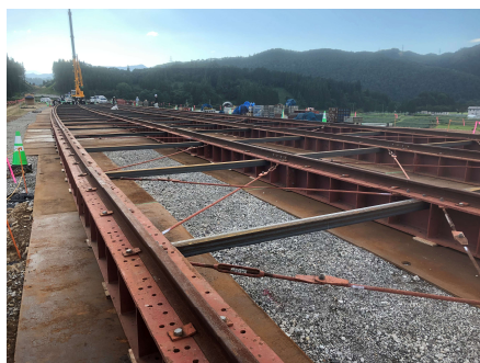
写真-1 軌条設備
