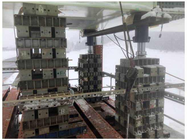
写真-9 桁降下設備
