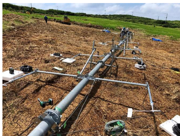
写真-2 センサーアームおよびセンサ設置状況
