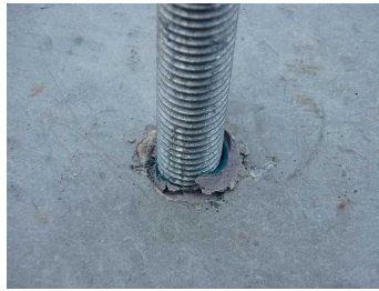
写真-4 引抜き試験後状況 (試験体 a-2)
