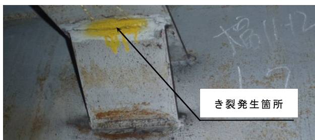
写真-2 軌道桁隅角部補強溶接部のき裂
