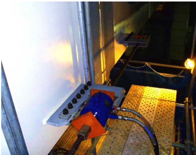
写真-7 引き込み装置
