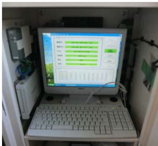
写真-2 風車内の騒音制御部
