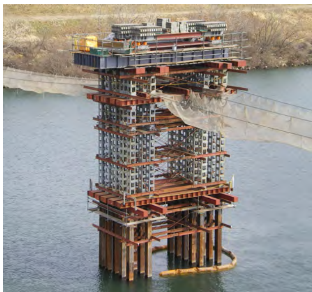
写真4 中間ベント設備
