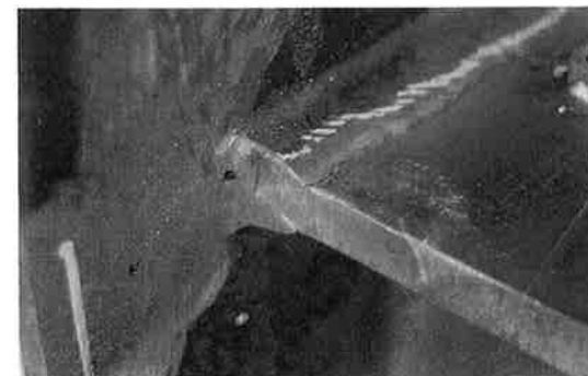
写真-4 CDP2 梁端接合部の亀裂
