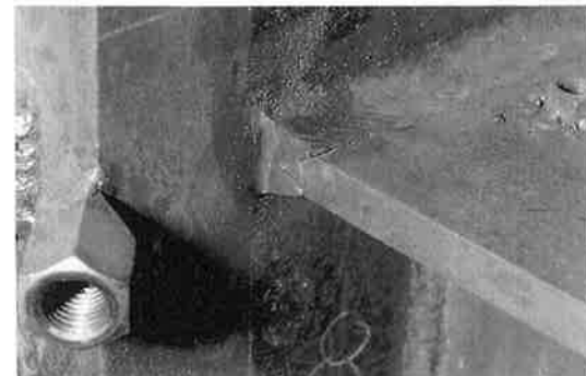
写真-3 CDP1 梁端接合部の亀裂
