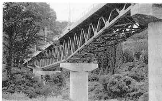
写真-6 東北新幹線 猿ヶ石川橋梁 (3径間連続上路ワーレントラス橋、 スパン 49.4 + 60.0 + 49.4 = 158.8\text{m} )
