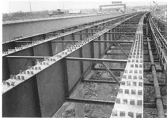
写真-5 テルウォール高架橋 （手前が旧橋、奥は供用中の新橋）
