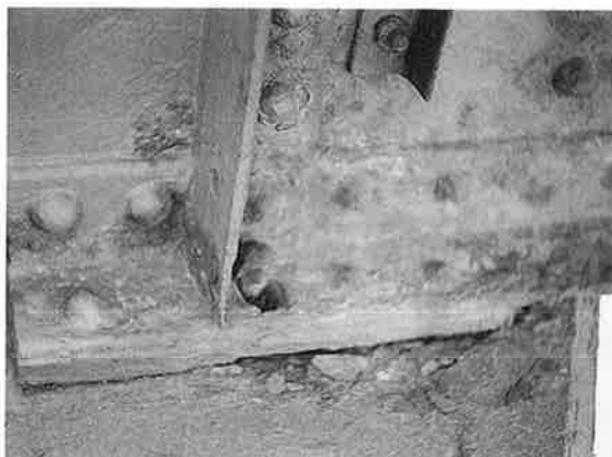
写真-5 リベット桁・鉄桁支承部の破損
