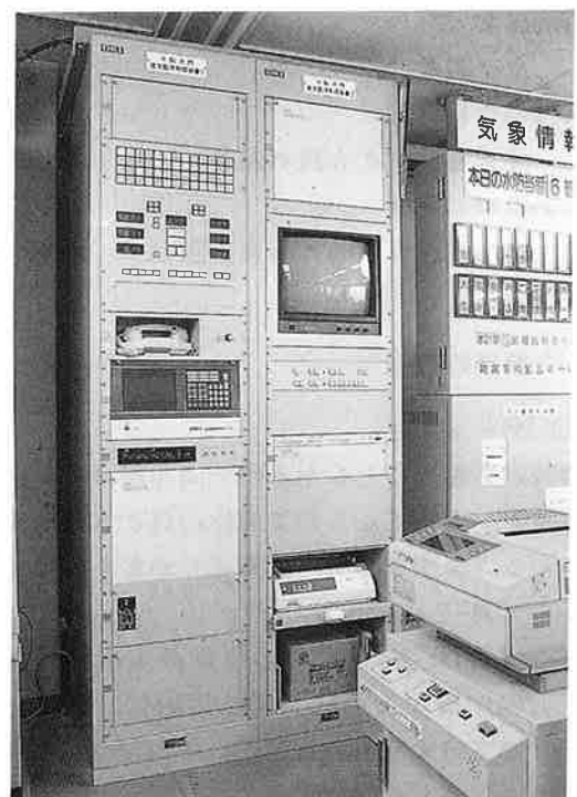
写真-1 遠方監視制御装置
