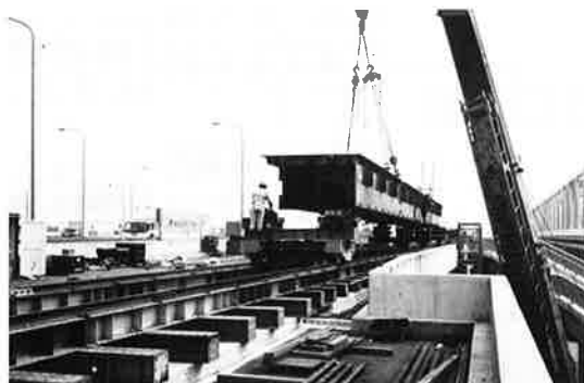
写真-1 軌条設備
