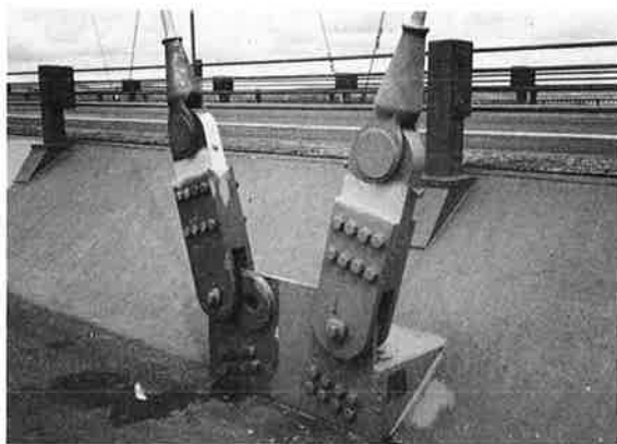
写真-13 ハンガー定着部の補修跡
