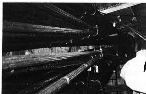
写真-4 Williamsburg 橋の Anchorage の中(主索の断線が見られる)
