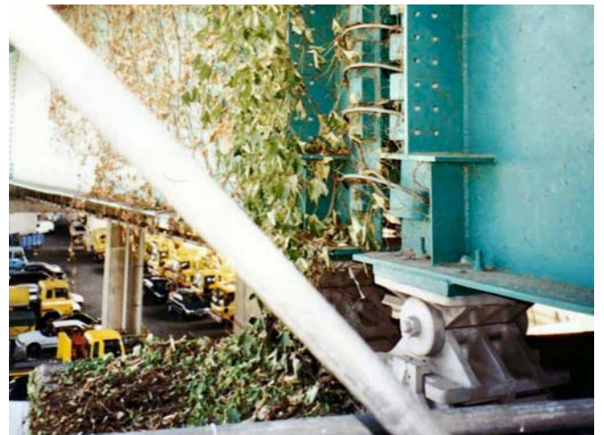
写真-3 現場状況変状の一例
