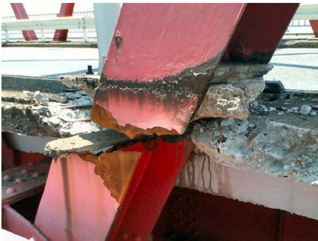
写真-1 木曾川大橋の鋼材破断
