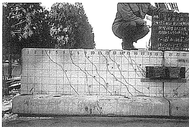
写真-10 損傷状況（樹脂モルタル側）
